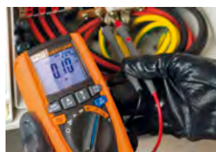
Durchgangsprüfung von Schutzleitern.
