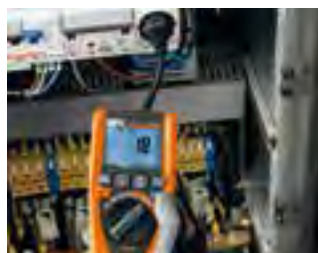
Impedanzmessung ohne RCD-Auslösung
