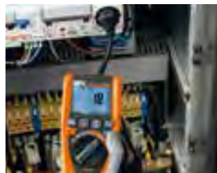
Impedanzmessung ohne RCD-Auslösung
