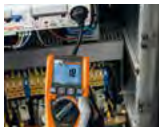
Impedanzmessung ohne RCD-Auslösung
