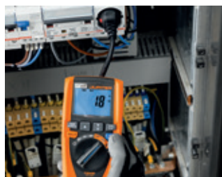
Impedanzmessung ohne RCD-Auslösung
