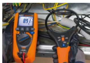
Messung des Stroms mit flexiblem Wandler.
