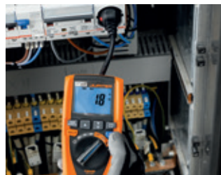
Impedanzmessung ohne RCD-Auslösung
